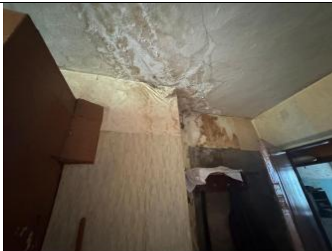
Ūdens uzkrāšanās radīti bojājumi griestos
